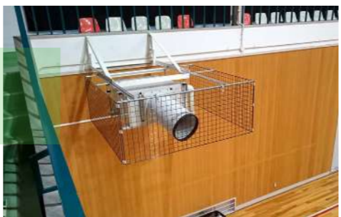
▲奈良県葛城市 市内体育館に設置された大型スポットクーラー
